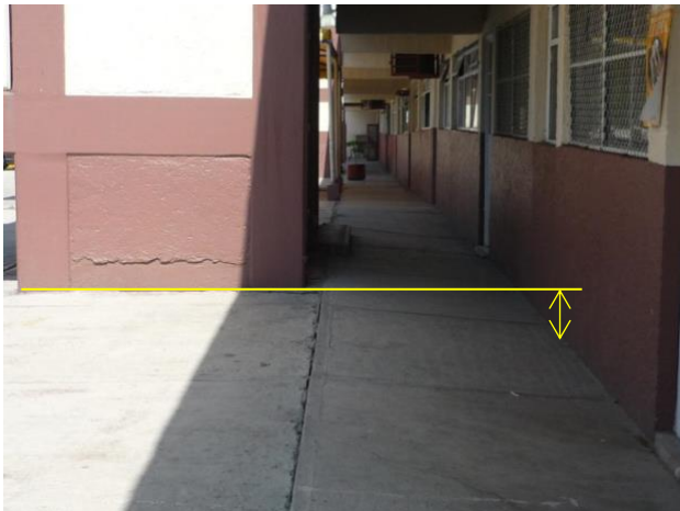
ASENTAMIENTOS DIFERENCIALES EN ESCUELA PRIMARIA LOCALIZADA EL SUR DE LA CIUDAD DE MÉXICO
